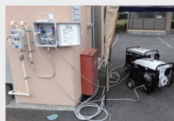
エルソナと分電盤を繋いで電力を供給
